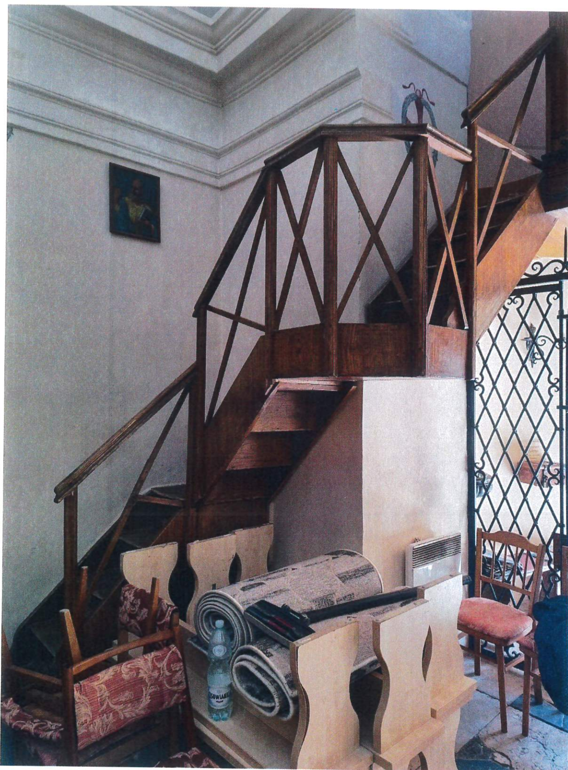
Fot.3. Grodzisko, Kościół pw. Wniebowzięcia NMP i św. Józefa Rzemieślnika, Schody od chóru. Widok ogólny na schody. Widoczne przetarcia ubytki struktury drewna. Stan przed konserwacją.
