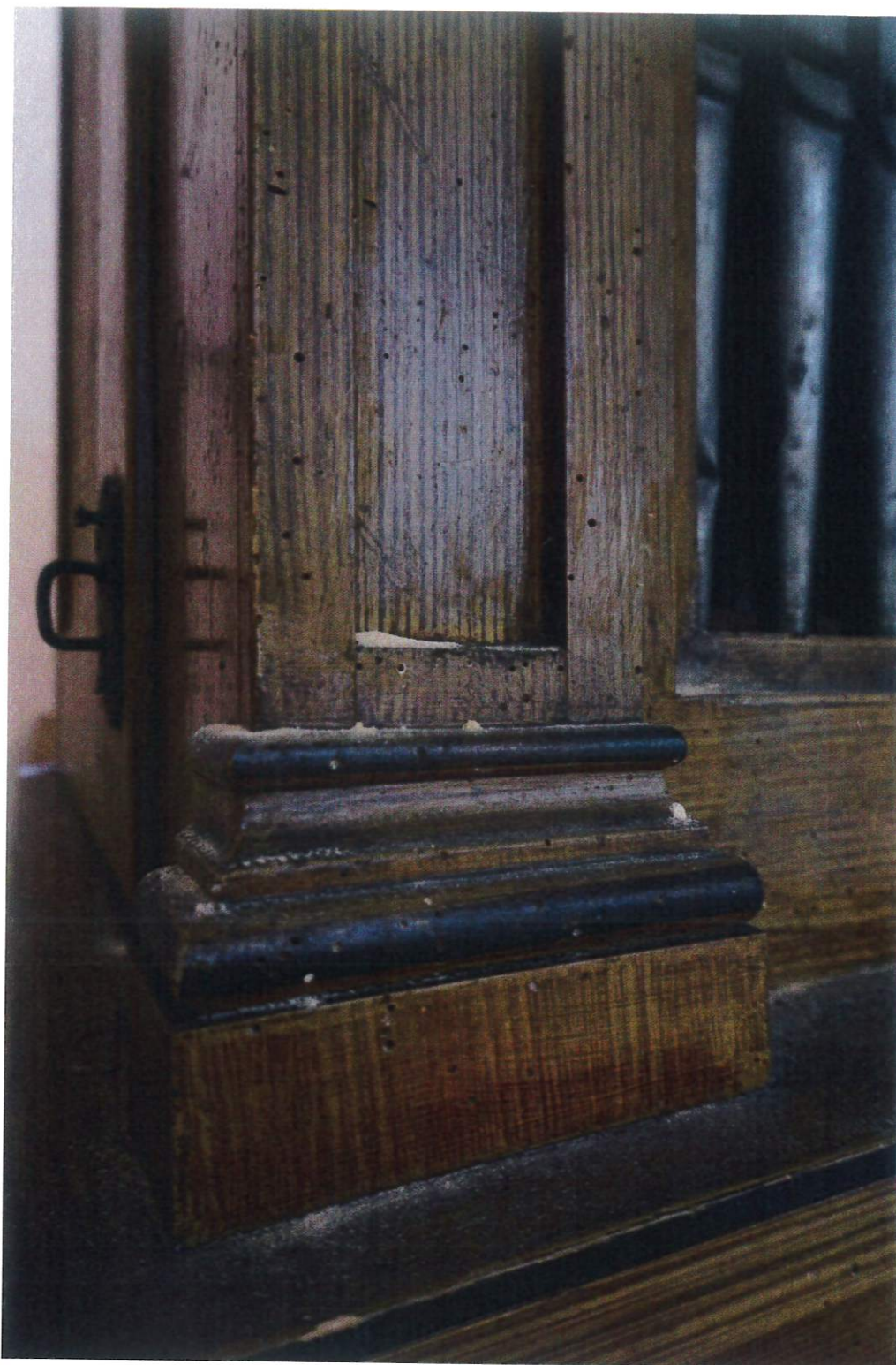
Fot.6. Grodzisko, Kościół pw. Wniebowzięcia NMP i św. Józefa Rzemieślnika, Prospekt organowy. Widok na detal prospektu. Widoczne ubytki powłoki zabezpieczającej powierzchnię, wysycenia żywiczne, ubytki, zabrudzenia i przebarwienia powierzchni. Stan przed konserwacją.
