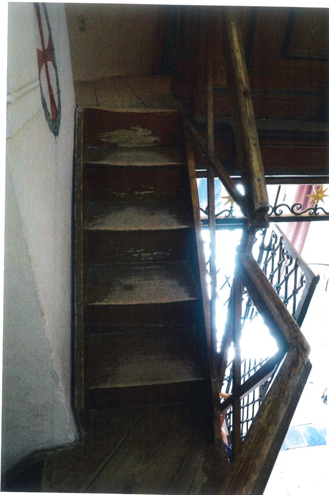
Fot.10. Grodzisko, Kościół pw. Wniebowzięcia NMP i św. Józefa Rzemieślnika, schody na chór. Widok na fragment schodów. Widoczne ubytki w warstwie malarskiej (monochromatycznej), przetarcia na barierce, ubytki, rozszczelnienia desek, zabrudzenia i przebarwienia powierzchni. Stan przed konserwacją.
