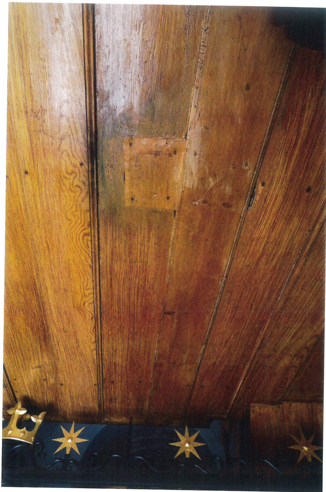
Fot.9. Grodzisko, Kościół pw. Wniebowzięcia NMP i św. Józefa Rzemieślnika, Chór-antresola. Widok na fragment spodu antresoli. Widoczne wtórne uzupełnienia, ubytki, przemalowania oraz zabrudzenia i przebarwienia powierzchni. Stan przed konserwacją.
