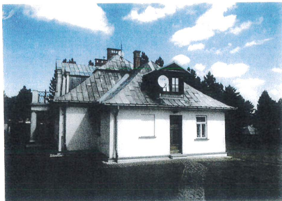
Fot. 4 Budynek parafialny kościoła p.w. , Matki Boskiej Różańcowej w Smardzowicach, przy ul. Kościelnej 12. Rok 2023, stan istniejący obiektu, przed konserwacją. Elewacja boczna, wschodnia, widok od strony płd.-wsch
