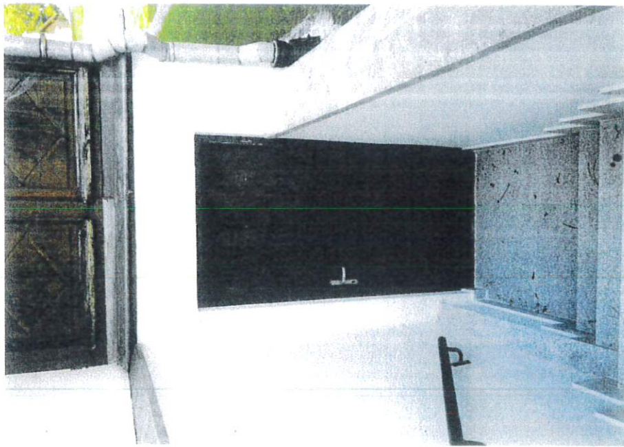
Fot.9 Budynek parafialny ks. p.w. . Matki Boskiej Różancowej w Smardzowicach. Rok 2023, stan istniejący obiektu. przed konserwacją. Fragment elewacji . pln. . widok wejścia do pomieszczeń piwnicznych, od strony płd. ogrodowej.
