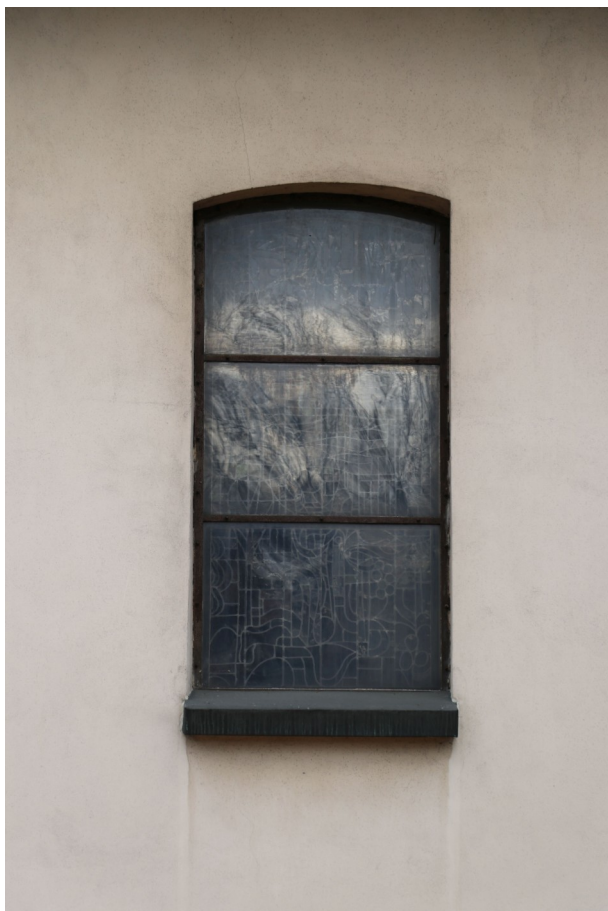
fot. 10: Widoczne zacieki z parapetu okna na powierzchni tynku elewacyjnego.
