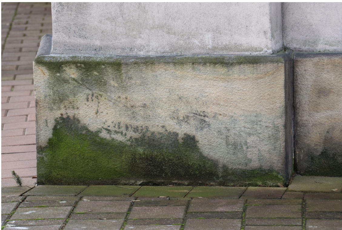
fot. 26: Wykwity glonów na cokole kamiennym elewacji północnej.
