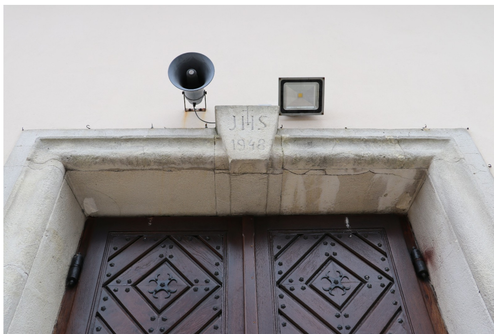
fot. 5: Spękania na linii łączenia elementów kamiennych oprawy wejścia.
