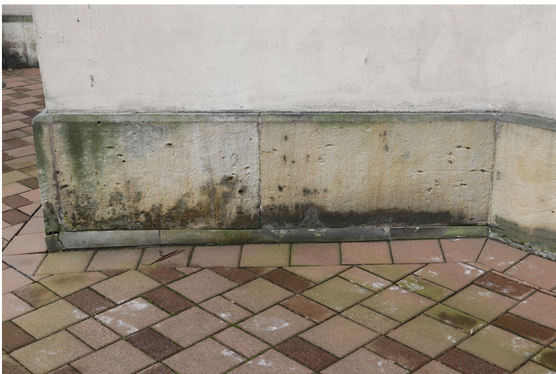
fot. 17: Nieestetyczne uzupełnienie dolnej partii cokołu kamiennego.
