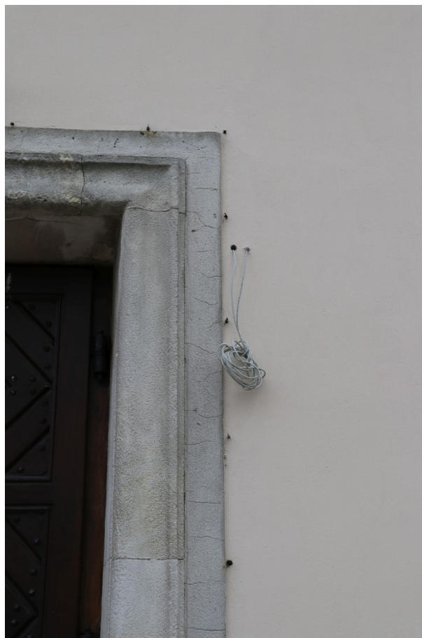
fot. 4: Uszkodzenia oprawy kamiennej wejścia elewacji zachodniej.
