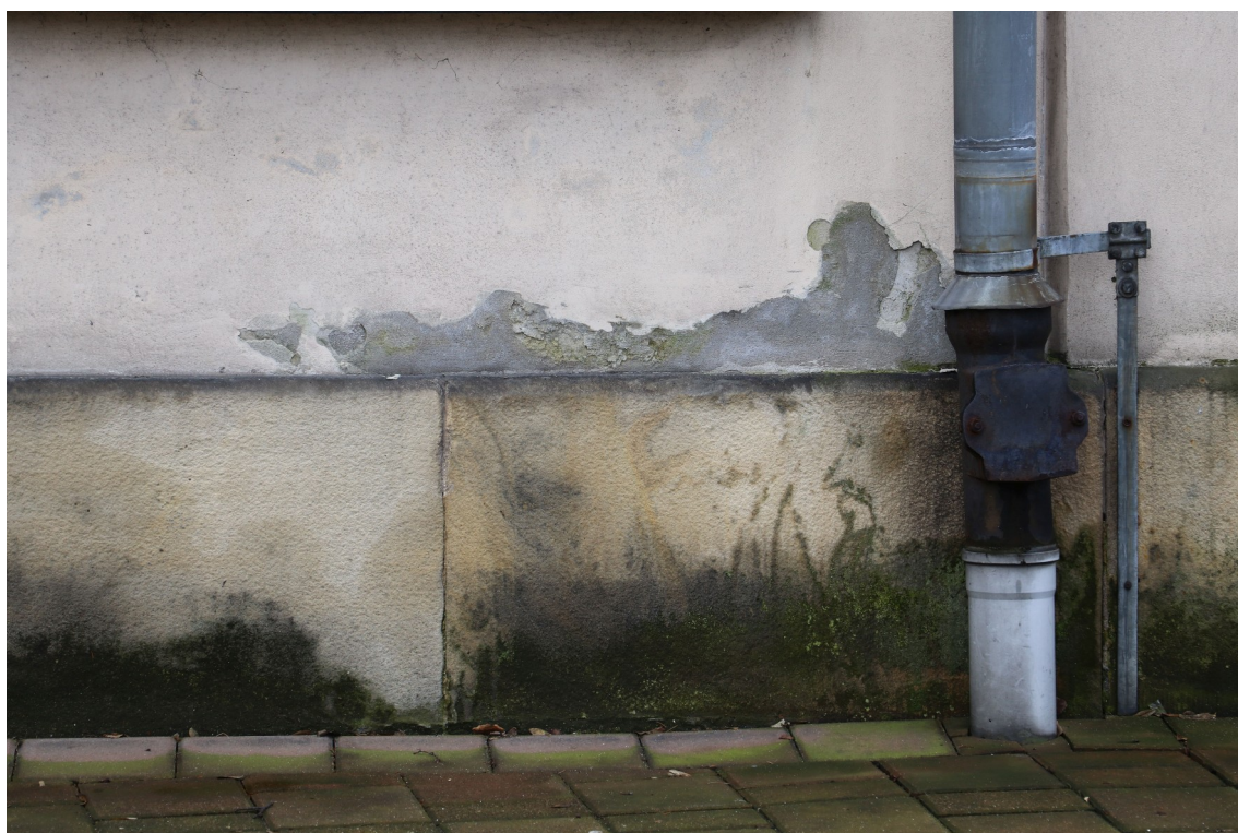
fot. 28: Zabrudzenia cokołu kamiennego oraz wtórne cementowe uzupełnienia tynku elewacyjnego.
