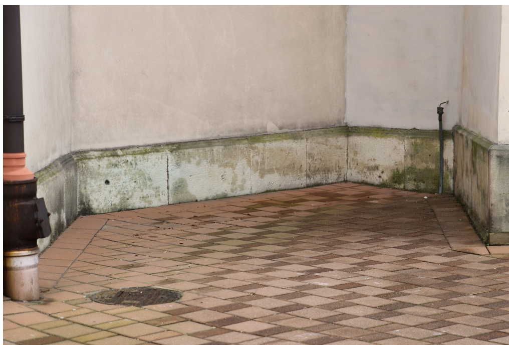
fot. 12: Wykwity glonów na powierzchni cokołu kamiennego elewacji południowej.
