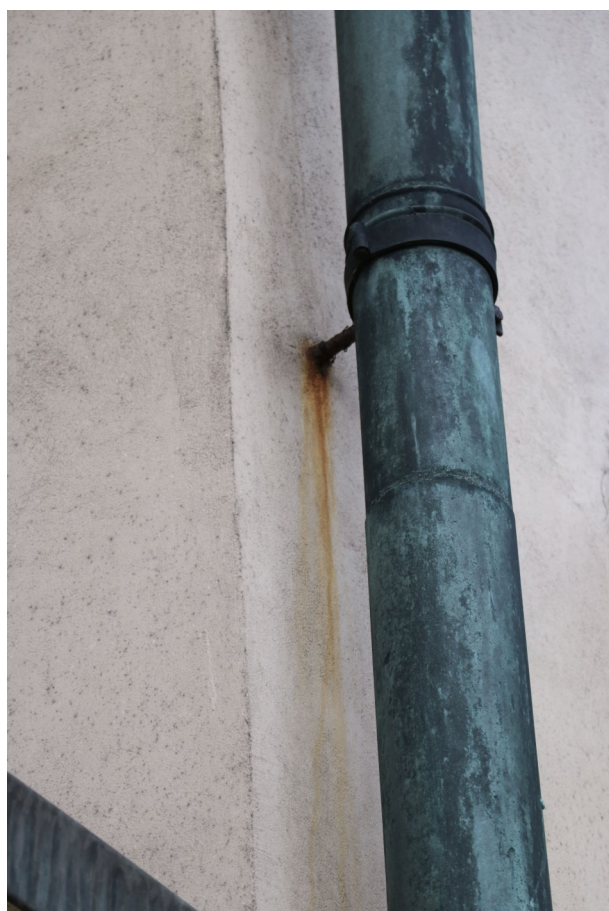
fot. 33: Zacieki rdzy na powierzchni tynku spowodowane korozją haków montażowych rury spustowej.
