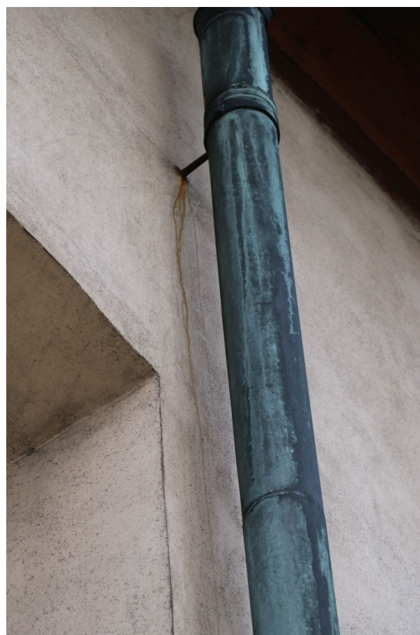
fot. 34: Zacieki rdzy na powierzchni tynku spowodowane korozją haków montażowych rury spustowej.
