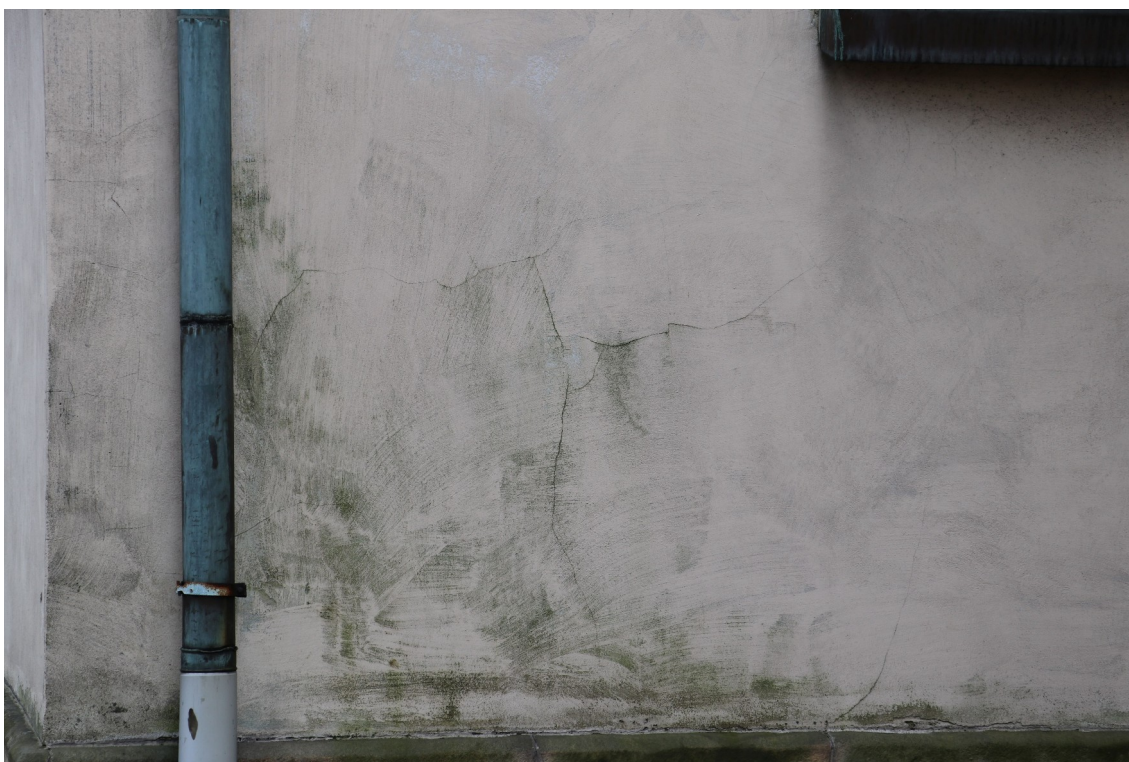
fot. 35: Spękania pajęczynkowe tynku elewacyjnego oraz zabrudzenia atmosferyczne i biologiczne.
