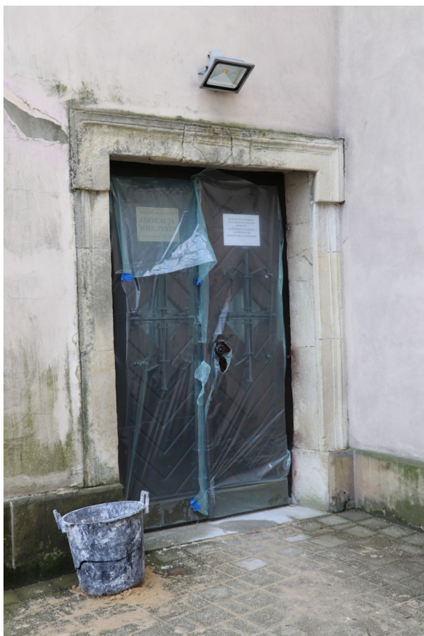
fot. 30: Kamienna oprawa wejścia do kaplicy-widoczne zabrudzenia powierzchniowe i nalot biologiczny.
