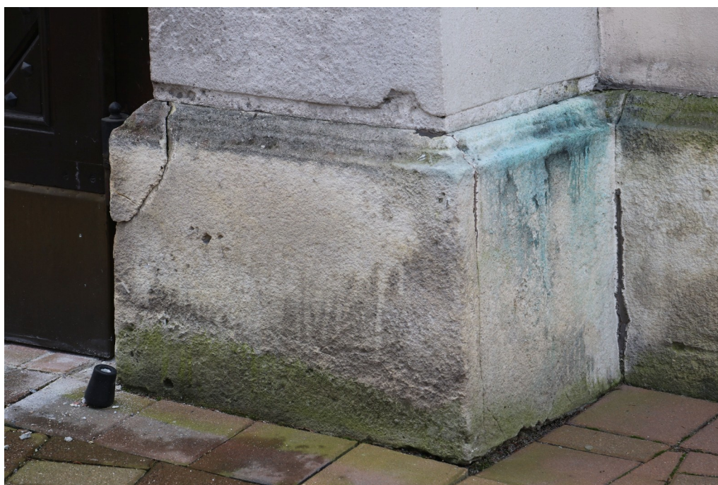
fot. 39: Uszkodzenia mechaniczne, nalot biologiczny oraz zacieki z patyny miedzianej na powierzchni cokołu kamiennego elewacji północnej.
