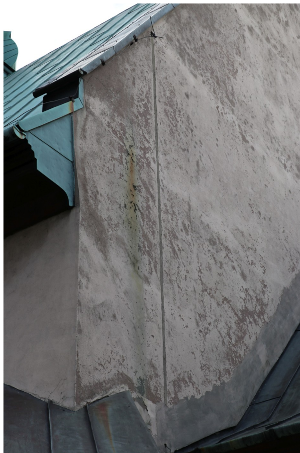
fot. 38: Uszkodzenia farby wierzchniej ściany szczytowej elewacji zachodniej korpusu.
