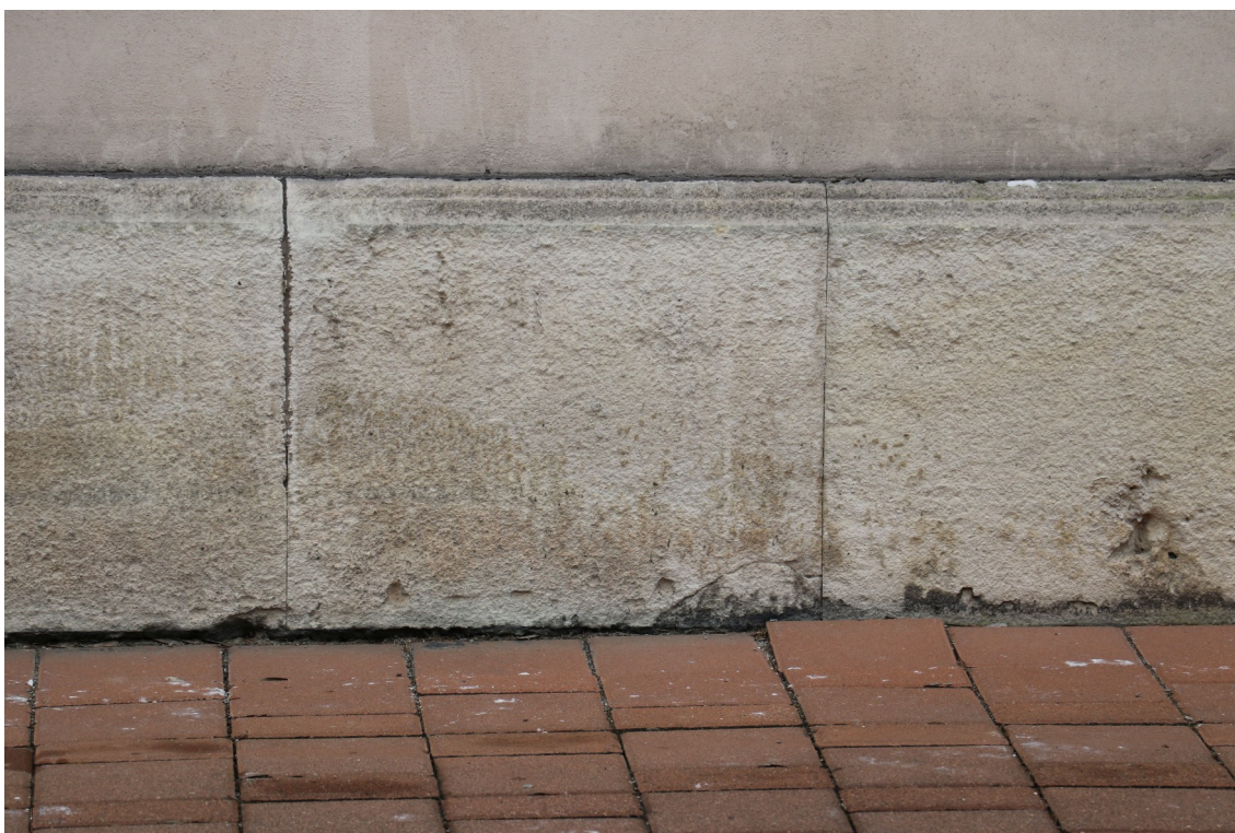
fot. 9: Zabrudzenia powierzchniowe oraz uszkodzenia części cokołowej.
