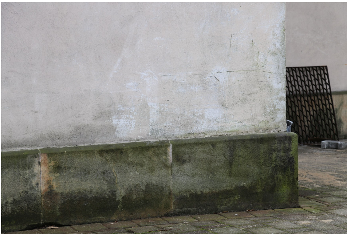
fot. 25: Zabrudzenia powierzchniowe oraz nalot biologiczny na cokole kamiennym elewacji północnej.
