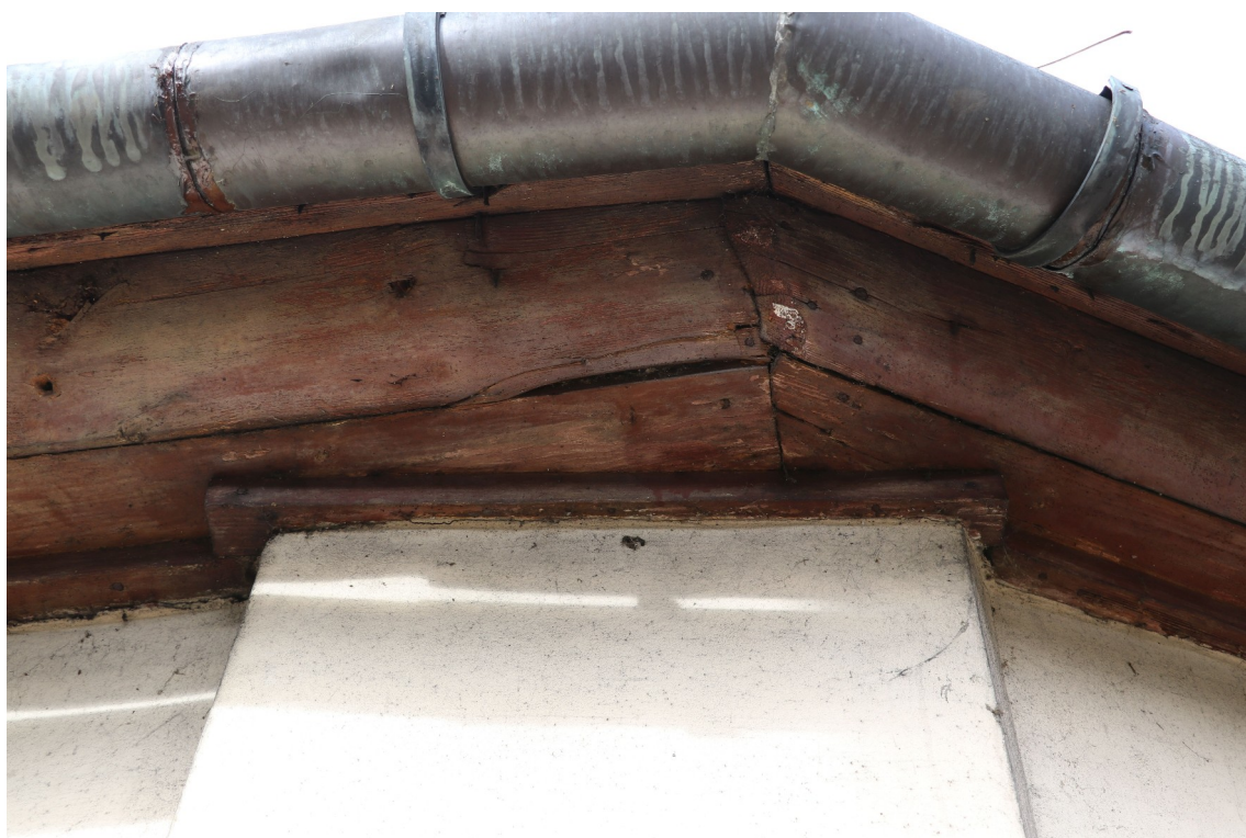
fot. 41: Widoczne szpary i uszkodzenie wierzchniej warstwy wykończeniowej podbitki pod okapem dachu.
