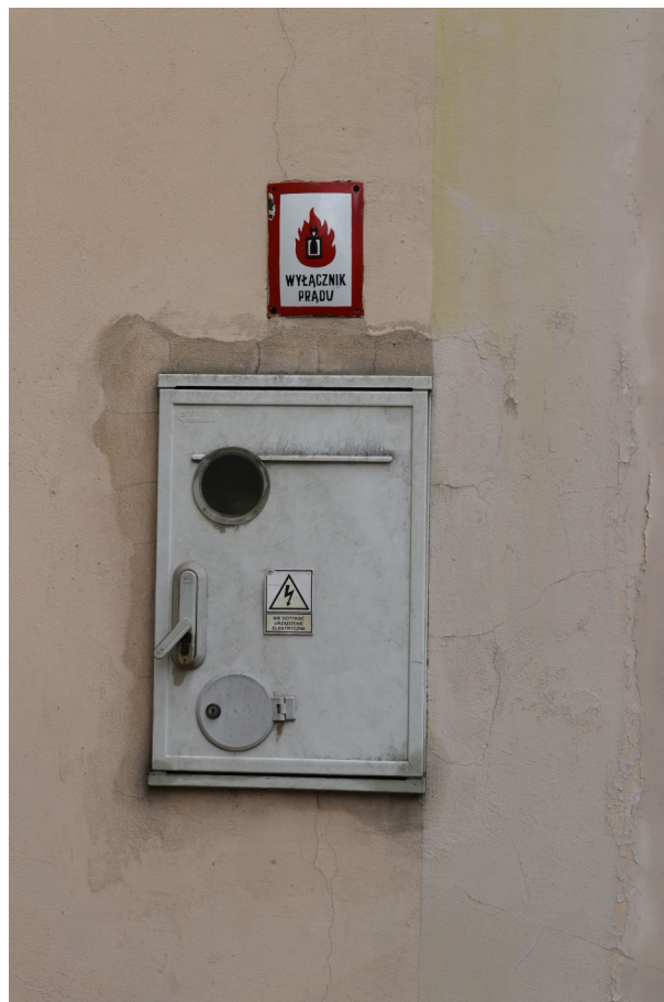
fot. 19: Skrzynka gazowa z nieestetycznie wykonanym uzupełnieniem zaprawą cementową.
