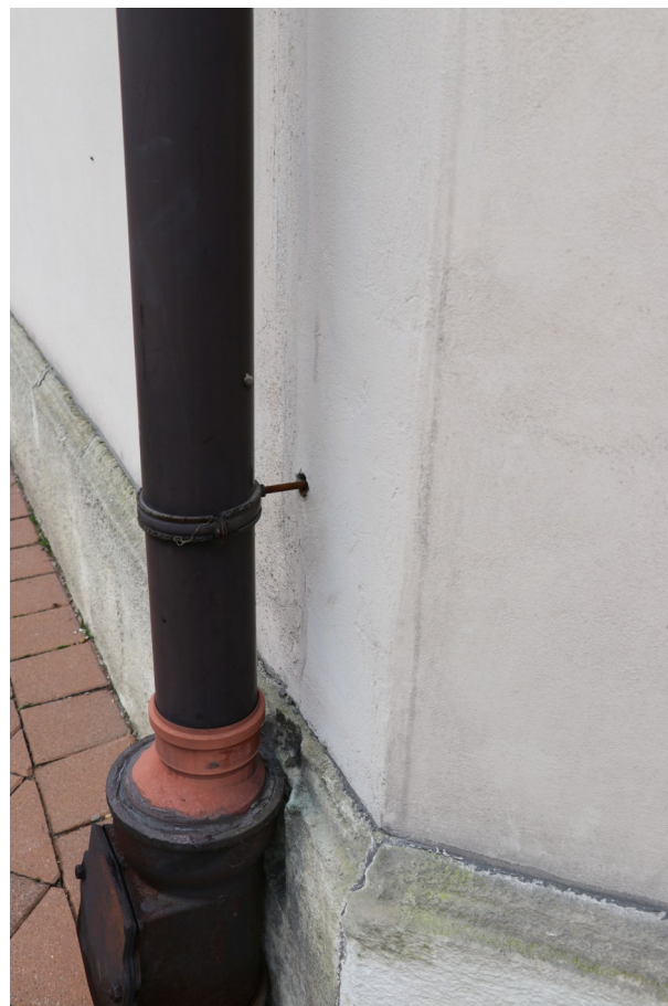
fot. 11: Nalot biologiczny na profilowaniu cokołu kamiennego.
