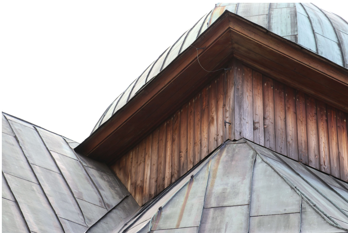
fot. 40: Uszkodzenia wierzchniej warstwy wykończeniowej deskowania szalunkowego oraz widoczne gwoździe montażowe.
