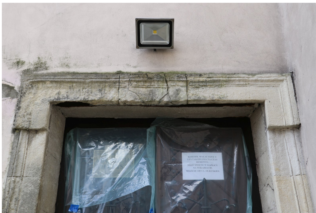
fot. 32: Fragment kamiennej oprawy wejścia do kaplicy-widoczne pęknięcia kamienia oraz nalot biologiczny.
