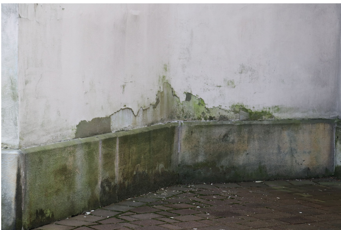
fot. 36: Ubytku tynku wierzchniego oraz nalot biologiczny na powierzchni tynku elewacyjnego i cokołu kamiennego elewacji północnej.
