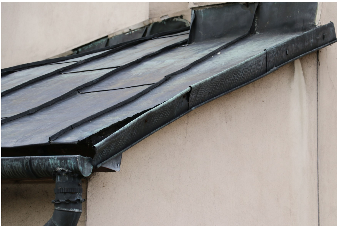
fot. 21: Odształcenie obróbki blacharskiej zadaszenia zakrystii.
