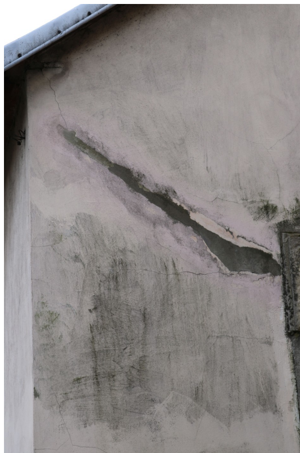
fot. 31: Wtórne uzupełnienia zaprawą cementową oraz zabrudzenia powierzchniowe tynku elewacyjnego.
