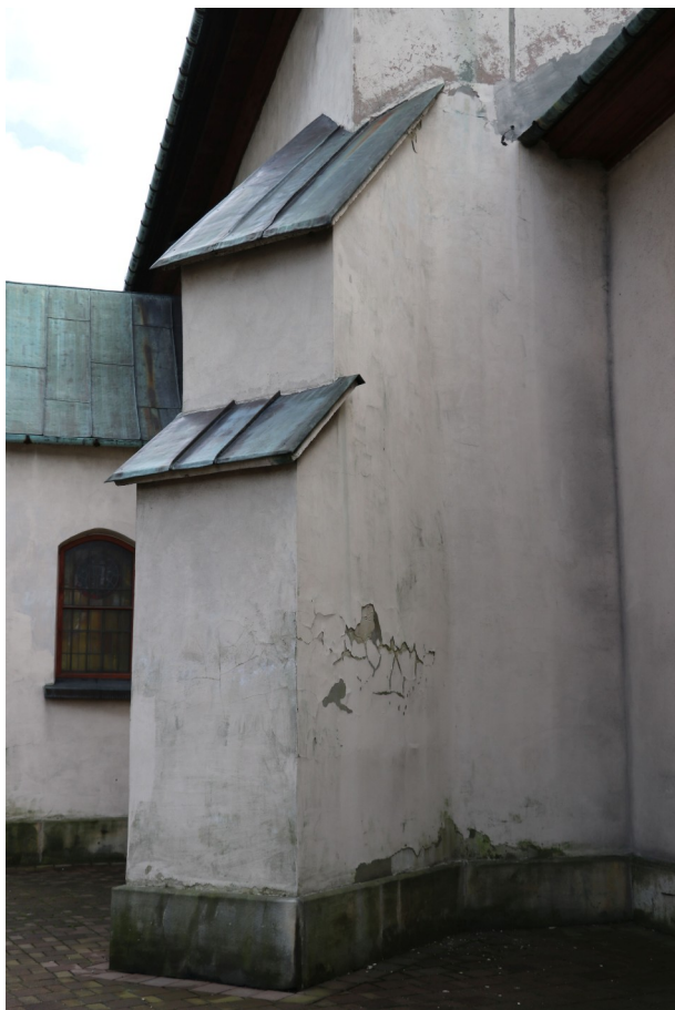
fot. 37: Spękania tynku na szkarpie narożnej korpusu elewacji północnej.
