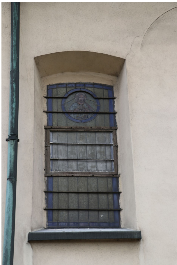
fot. 18: Pęknięcie nadproża otworu okiennego okna witrażowego.
