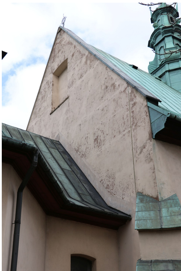
fot. 13: Widoczne uszkodzenia farby wierzchniej ściany szczytowej zachodniej korpusu kościoła.
