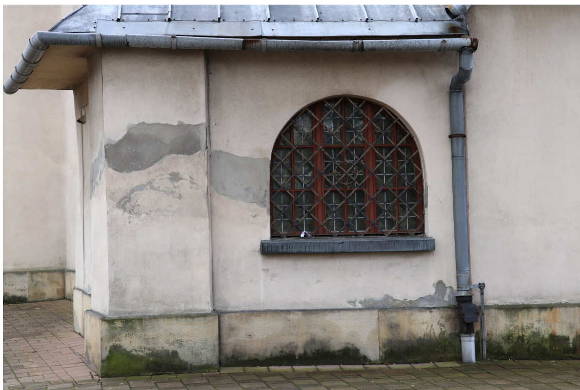
fot. 24: Widoczne wtórne uzupełnienia zaprawą cementową na powierzchni tynku zakrystii - elewacji północna.
