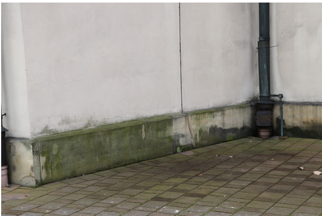
fot. 22: Nalot biologiczny w postaci wykwitów glonu na powierzchni cokołu kamiennego elewacji wschodniej.
