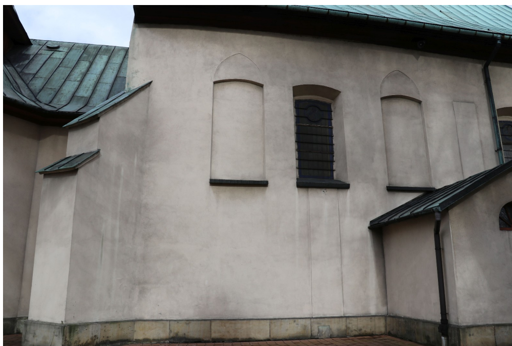
fot. 15: Widoczne zabrudzenia atmosferyczne oraz zacieki na powierzchni tynku elewacyjnego od strony południowej.
