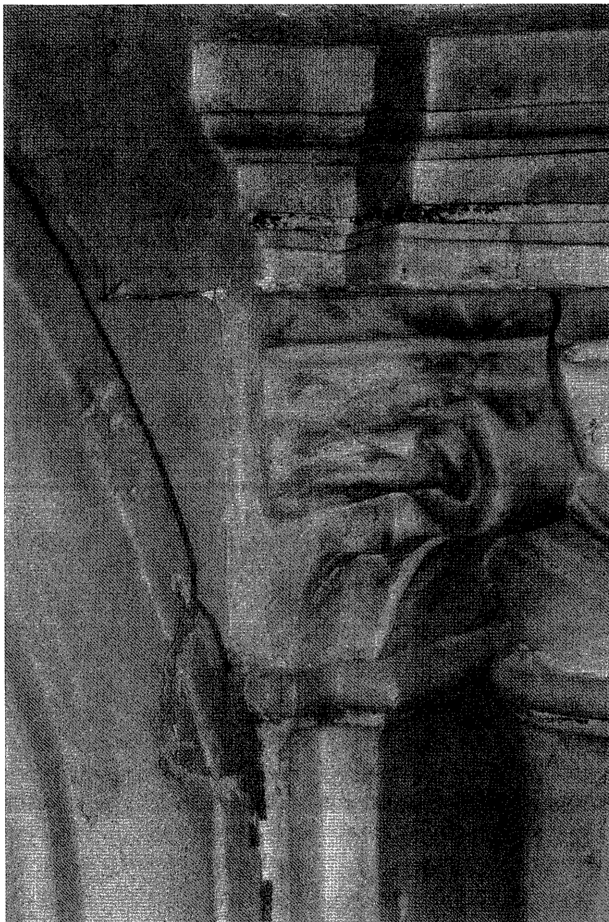
Fot. 5.1.33. Grodzisko 7, 32-043 Skała, kościół p.w. Wniebowzięcia NMP i św. Józefa Rzemieślnika, OŁTARZ ŚW. MARII MAGDALENY. Stan zachowania detalu architektonicznego, widoczne ślady złoceń. Fot. J. Kunert, listopad 2017.
