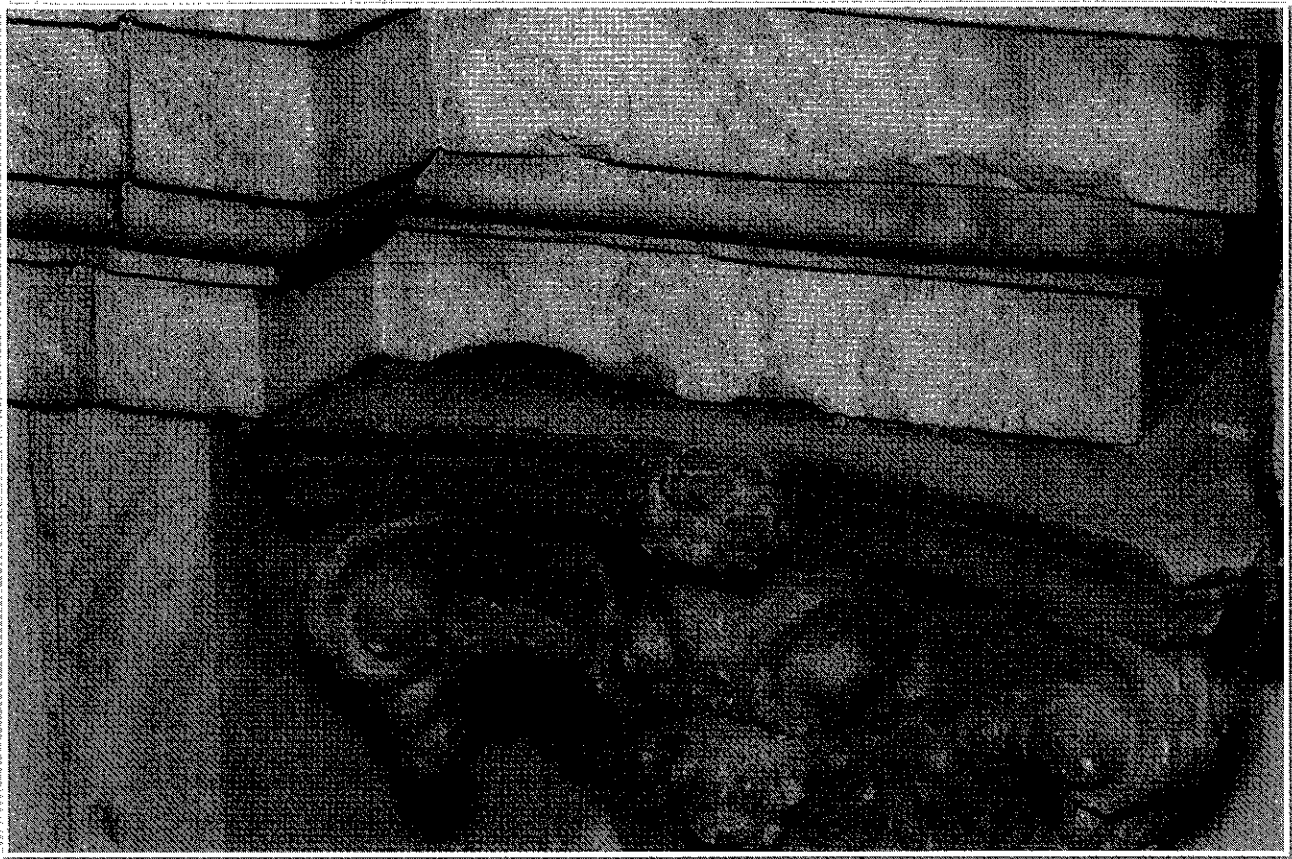
Fot. 5.1.23. Grodzisko 7, 32-043 Skała, kościół p.w. Wniebowzięcia NMP i św. Józefa Rzemieślnika, OŁTARZ BŁ. SALOMEI. Stan zachowania detalu architektonicznego. Fot. J. Kunert, listopad 2017.
