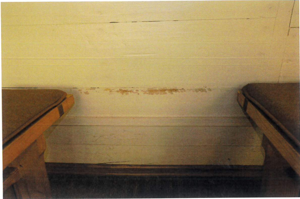
Fot. 6. Kaplica na Wodzie w Ojcowie, wewnątrz. Stan przed konserwacją. Widoczne zniszczenia mechaniczne w postaci obić, zarysowań i zabrudzeń.
